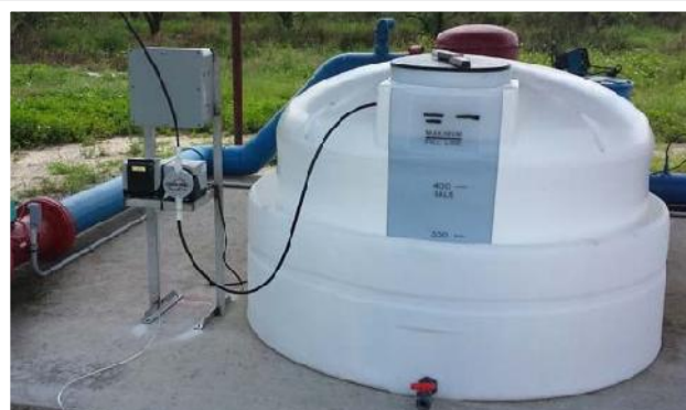
شکل ۲- نمونه ای از تانکر و سیستم تزریق اسید در آب آبیاری
