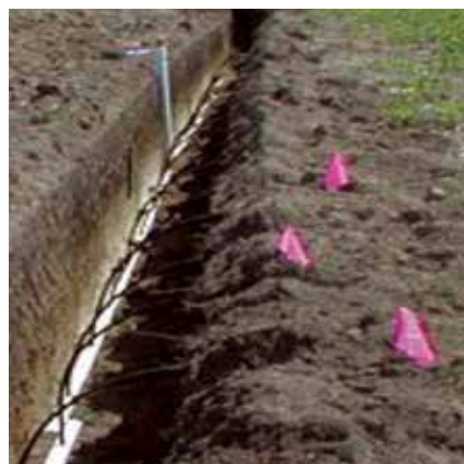
شکل ۲. سیستم نصب شده در زیر زمین
